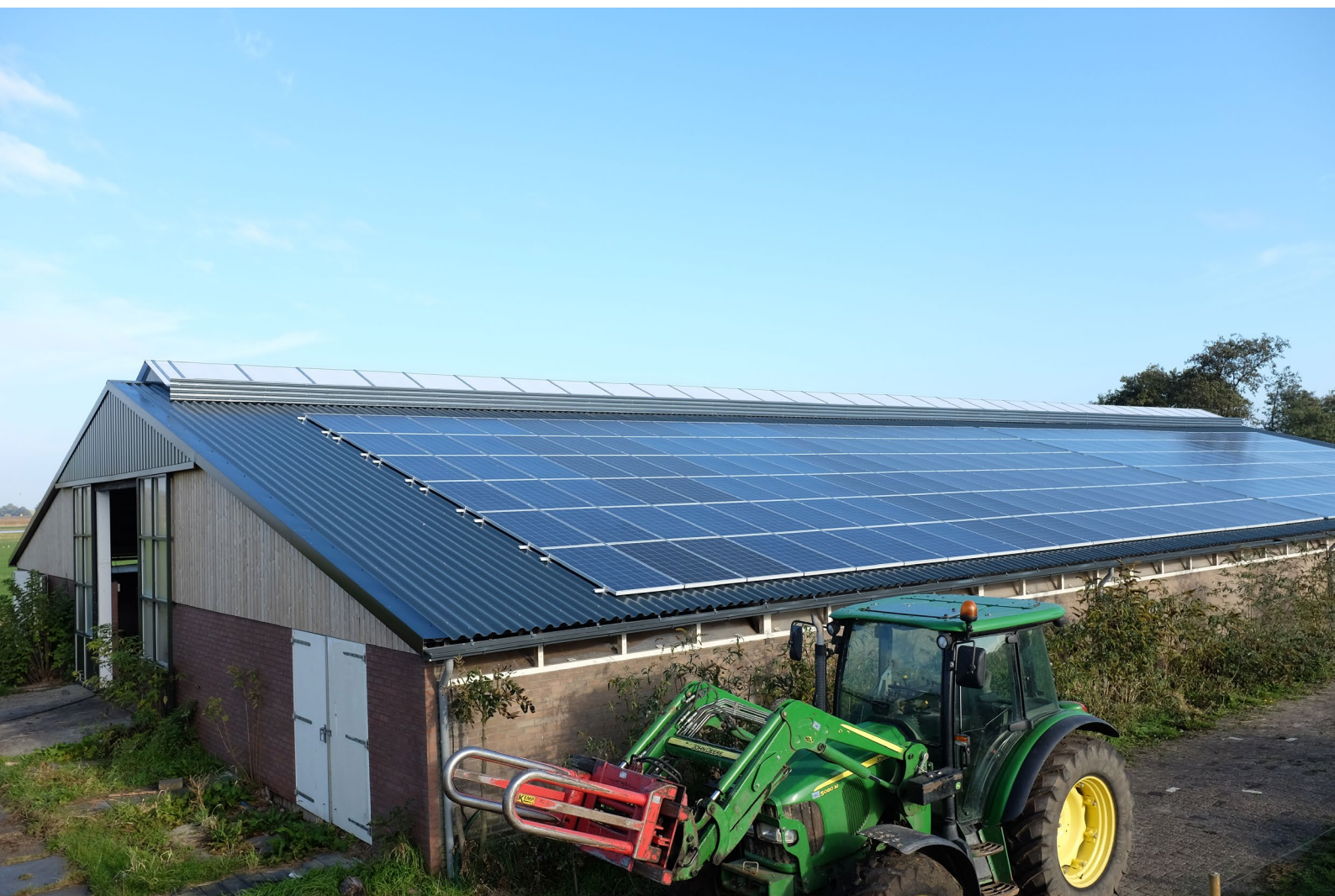
Zonnepanelen op het dak van de stal van zorgboerderij Dijkgatshoeve in Wieringerwerf
